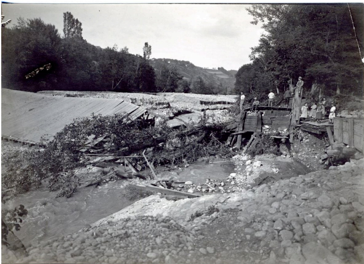
Zerstörte, hölzerne Müllerschwelle nach dem Zulg-Hochwasser vom 27. Juli 1907, der Einlauf vom Mühlbach am linken Zulgufer ist ebenfalls zerstört, der Bachrand dort abgestürzt.
