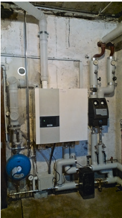
Neue Gasheizung in der Villa Schüpbach
