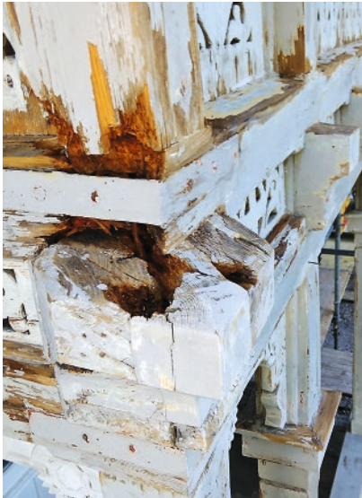
Balkonstützen Südfassade vor der Sanierung.
